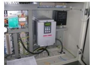
Inverter elettronico per la gestione dei vibratori dello stampo
